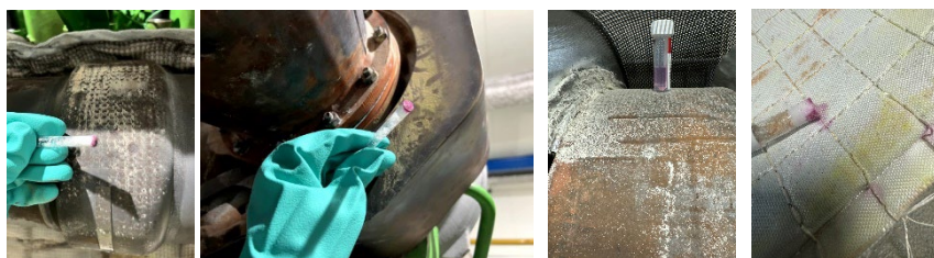
Fig. 1-4: Chromaatafzettingen tussen het hete metaaldeel en de thermische isolatie<11>
